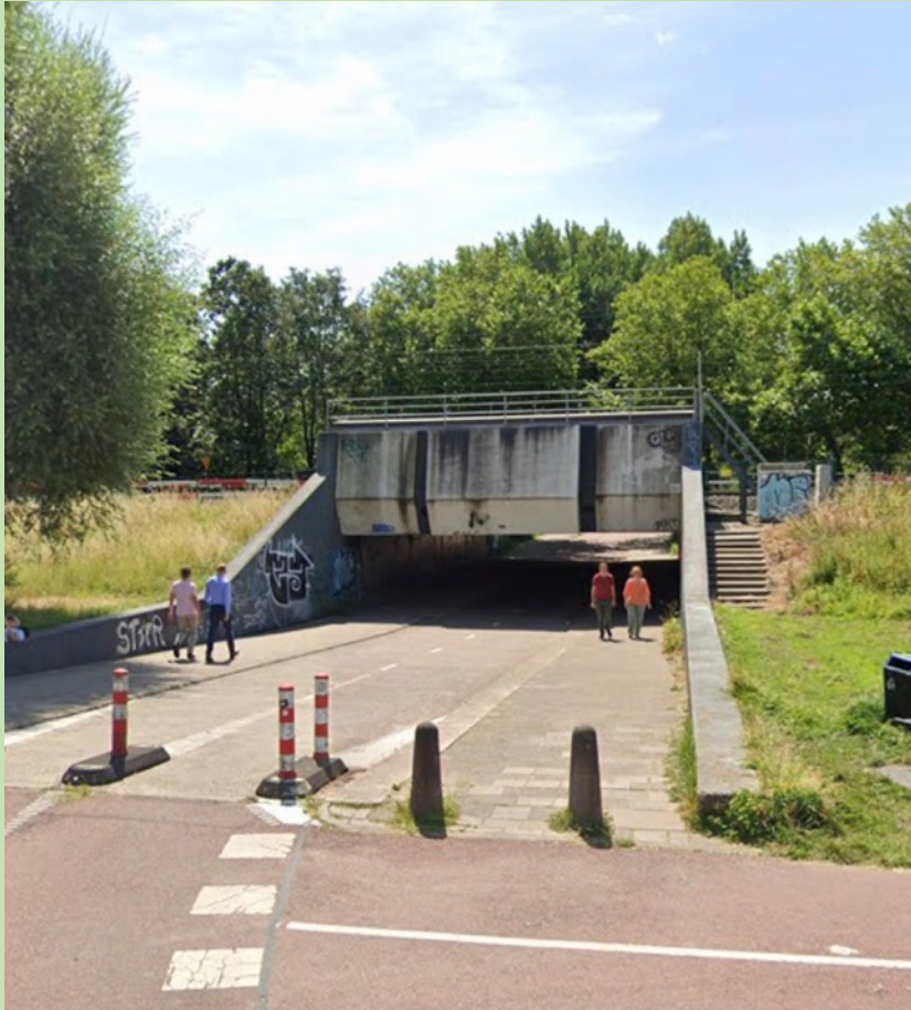
Het gat in de waterkering nabij dorp Sloterdijk
