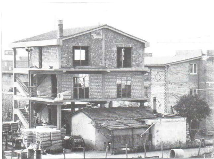
11. De ontwikkeling van de illegale woningbouw: een nieuw betonskelet over het oude huisje heen
